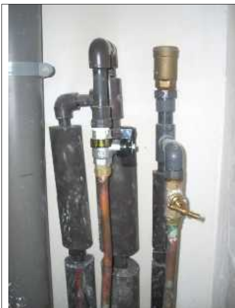
Photo 8 : Piquage du dernier point d'usage
