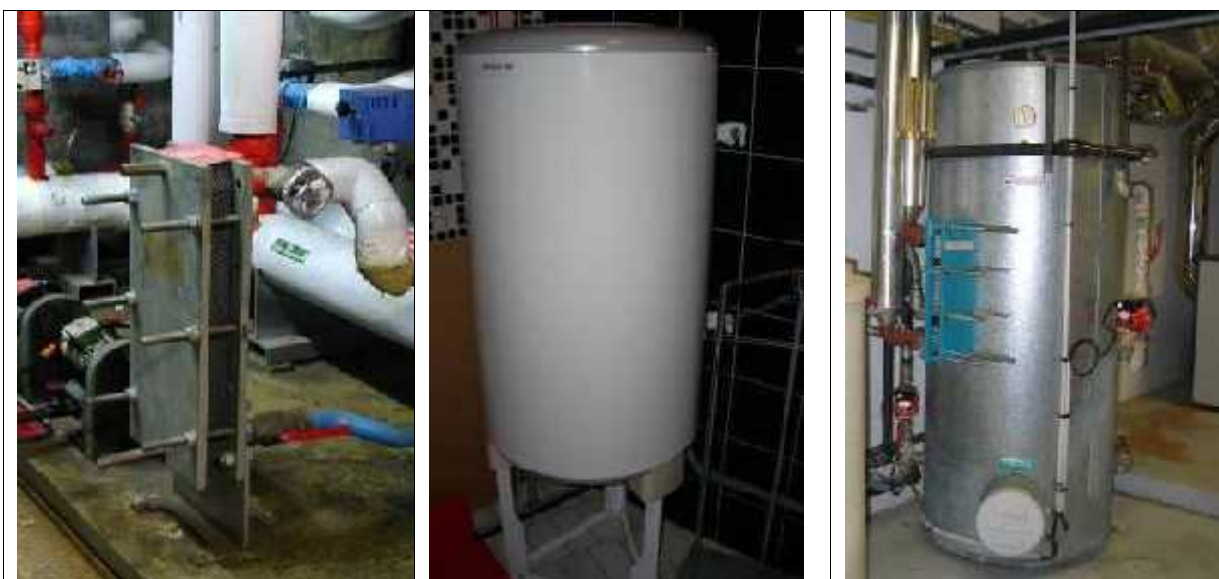
Photos 1 à 3 : exemple d'équipements de production d'ECS (de gauche à droite : échangeurs à plaques, ballon de production, production semi-instantanée)
