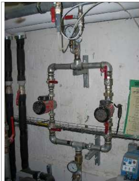
Photo 4 : exemple de pompes de recirculation
