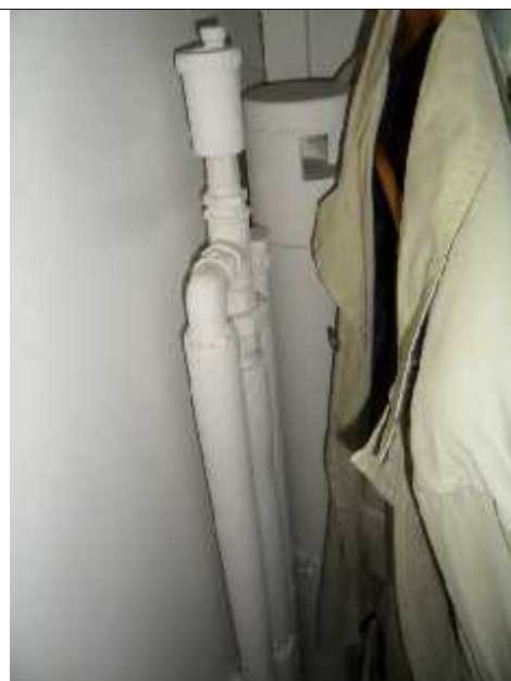
Photo 9 : haut de bouclage avec dégazeur
