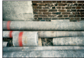
© INRS Canalisation en amiante
